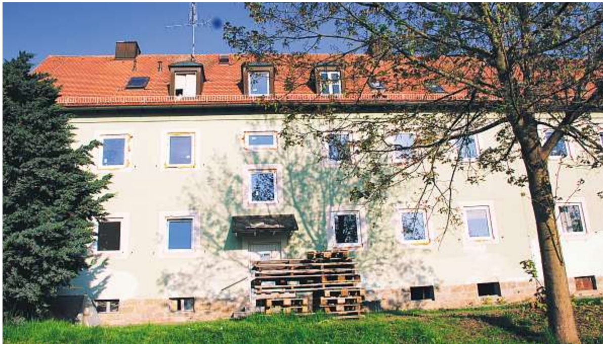
Wohnungen in solchen sanierungsbedürftigen Mehrfamilienhäusern wie hier im Breitenwiesweg in Waldmünchen verkaufte die Ingolstädter Immobilienfirma zu überhöhten Preisen. Foto: Hiob
